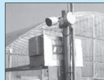
防犯カメラの設置
