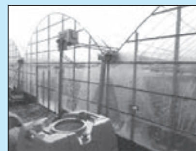
防犯カメラの設置
